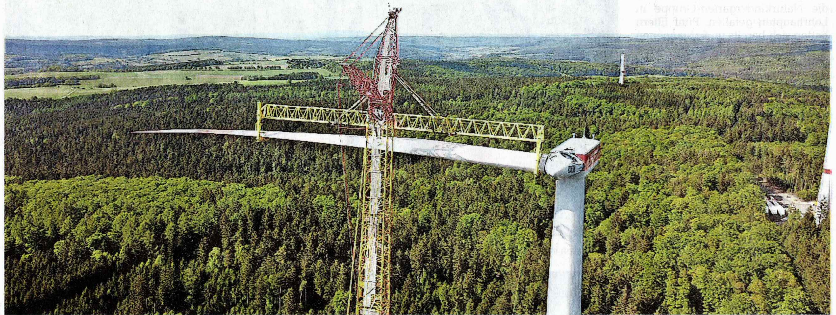
Der Windpark Roßkopf während der Bauphase. In wenigen Tagen werden die sechs Anlagen vom Typ „GE 2.75“ an den Betreiber übergeben.
